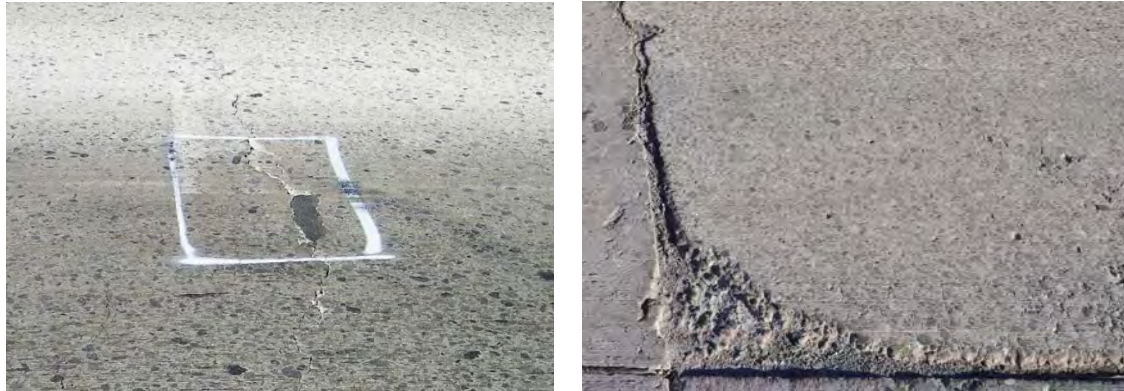
a) Transverse crack b) Slab corner
